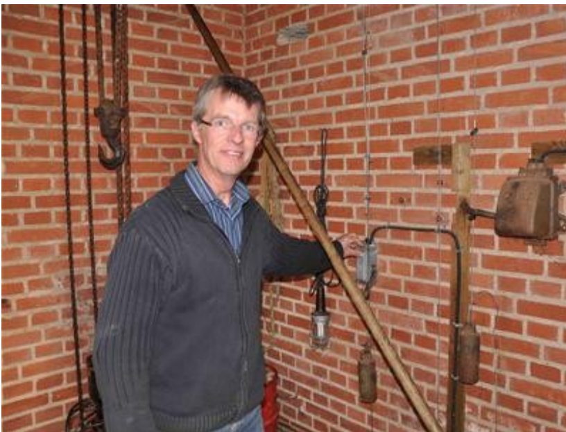
Poul Roesen inde i pumpehuset ved den kontakt, der skal slukkes, når afvandingen ophører. Foto: Helge Røjle © DR
